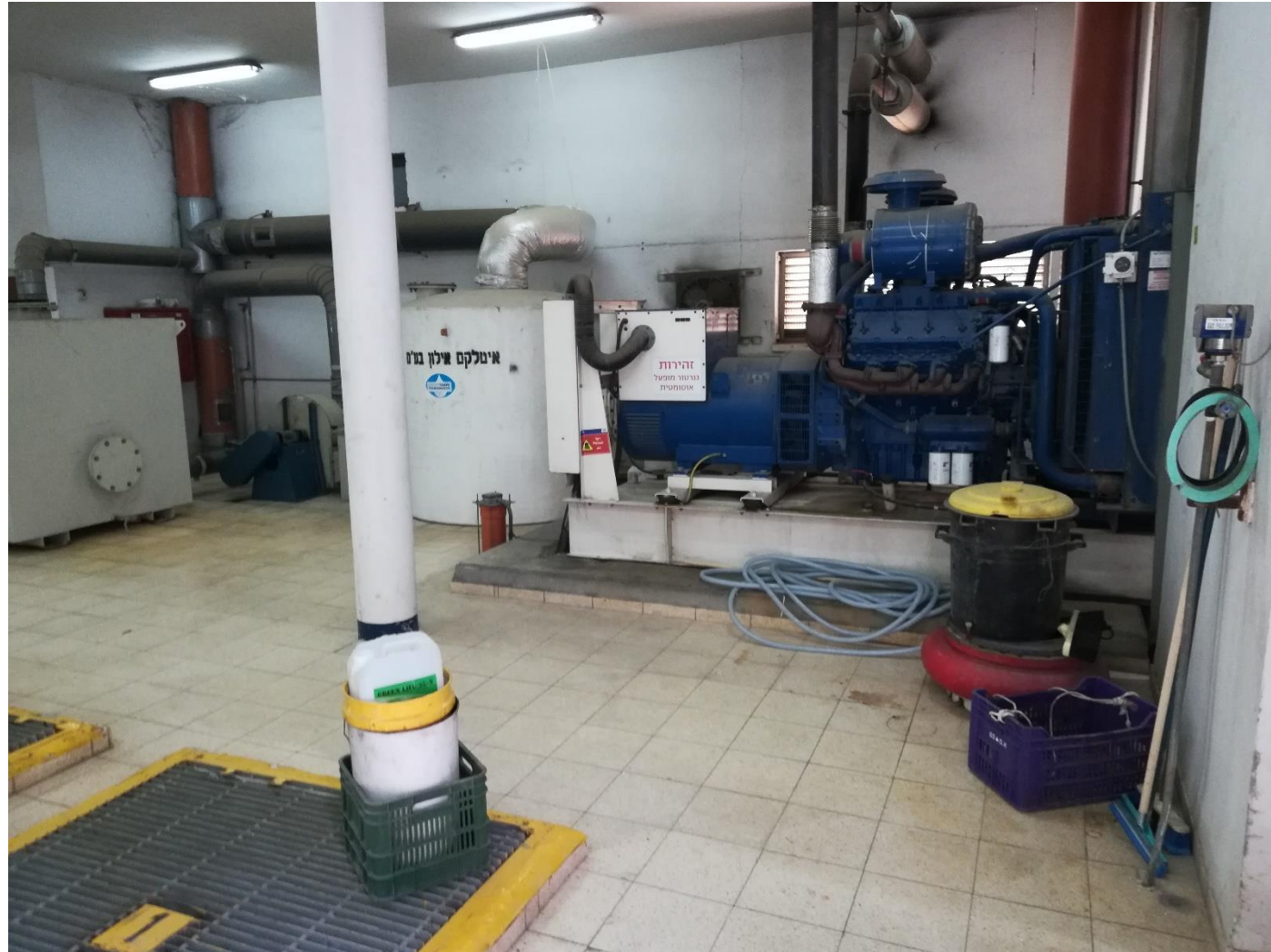
גנרטור חירום 500 KVA
